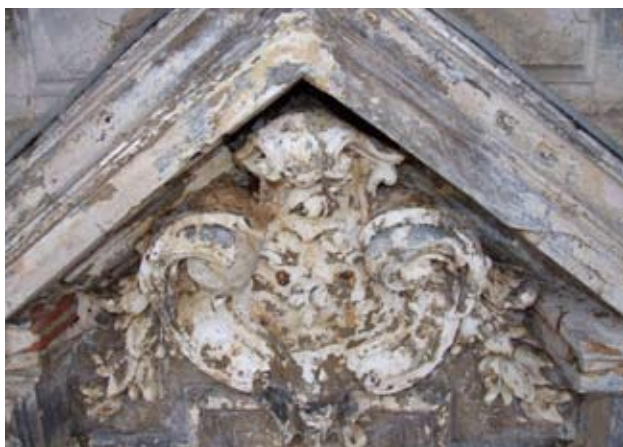
Spatzennest hinter Stuckelement vor der Sanierung
