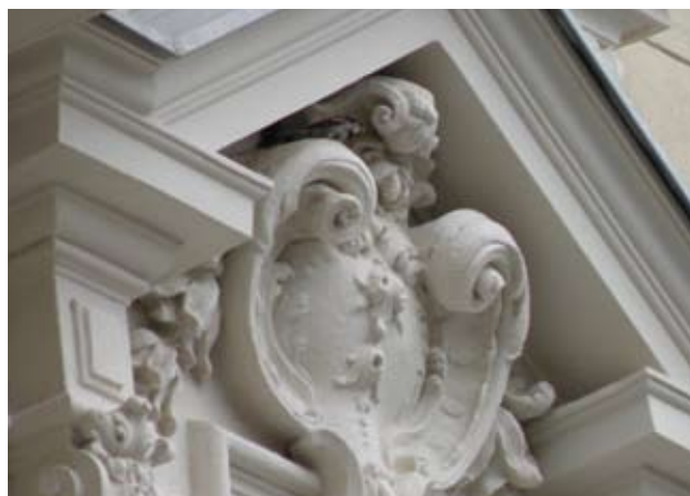
Spatzennest hinter saniertem Stuckelement
