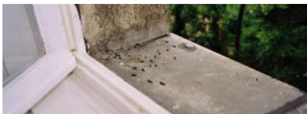
Kotkrümel auf der Fensterbank unter einem Quartier
